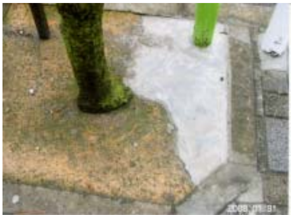
写真3 根元の一部がさらにコンクリートで固められている。
